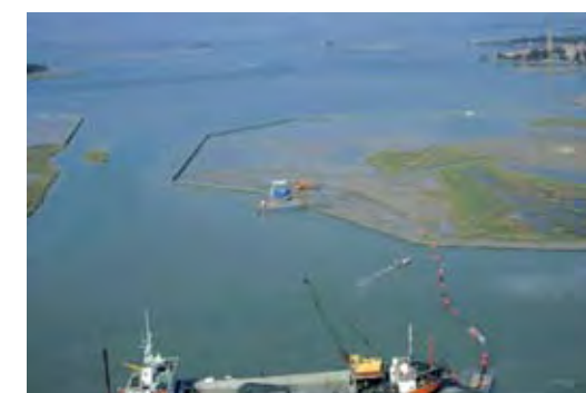
Figura 5: realizzazione di strutture morfologiche artificiali. STADIO 0: refluento di miscela di sedimento e acqua entro conterminazioni. Già nella prima fase di realizzazione si creano aree favorevoli all'alimentazione e alla nidificazione dell'avifauna.
