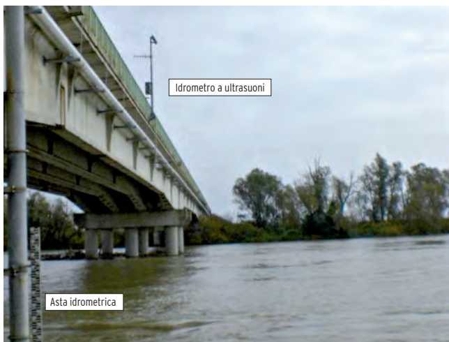
Figura 2b: panoramica dell'installazione per il monitoraggio idrometrico (asta idrometrica e teleidrometro) sul Po di Gnocca.
